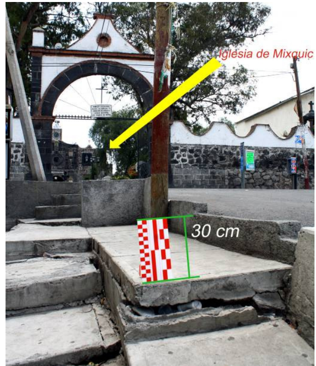
Figura 2. Entrada del atrio de la Iglesia de San Andrés Mixquic, donde se aprecian los efectos del hundimiento regional y la presencia de anomalías prehispánicas
