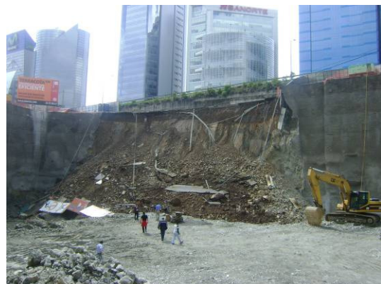
Figura 2, Vistas exterior e interior del deslizamiento.
