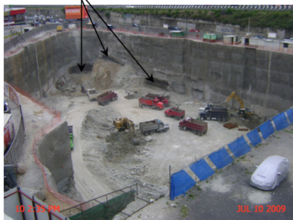
Figura 8. Vistas de las irregularidades y bolsas de caídos al pie de la excavación previas al deslizamiento general.
