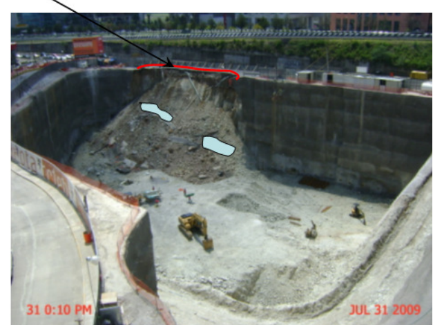
Figura 9. Sobreposición de las bolsas o caídos previos sobre el deslizamiento general.
