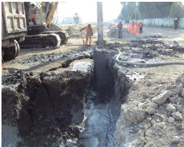
Figura.10. Agrietamientos y caídos en zanjas
