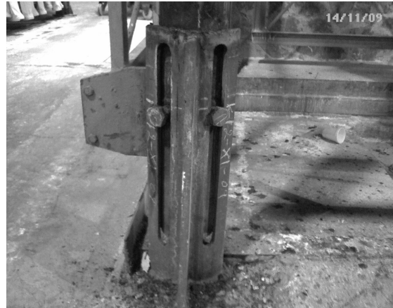
Figura 9. Desligue de elevador del Pasillo Central
