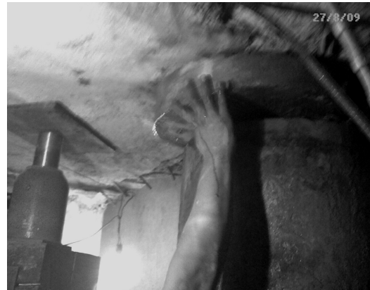
Figura 15. En esta imagen se aprecia la extracción del segmento de pilote cortado
