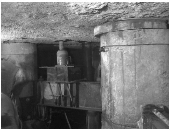
Figura 13. Se aprecia las vigas de acero soportando las cargas del edificio a través de los gatos hidráulicos
