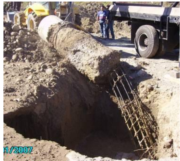
Figura. 12. Extracción de la pila ensayada. Obsérvese la ausencia de concreto a los 1.5m de profundidad
