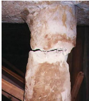
Figura 10 Discontinuidad de la sección de la pila.
