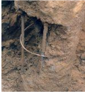
Figura 9. Contaminación del concreto de la pila
