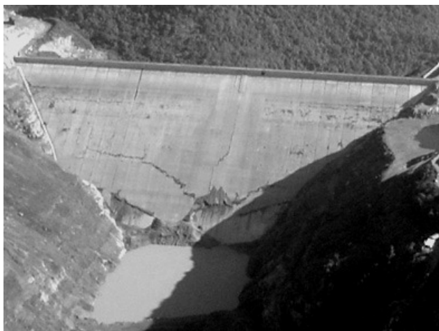
Figura 1. Agrietamiento en la cara de concreto de la presa Campos Novos, en Brasil, junio de 2006.
